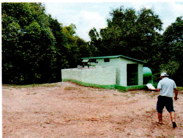
Imagem 03- Sistema de contenção, com bombeamento com motor a diesel
